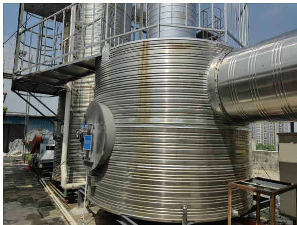
填料过滤脱水塔
