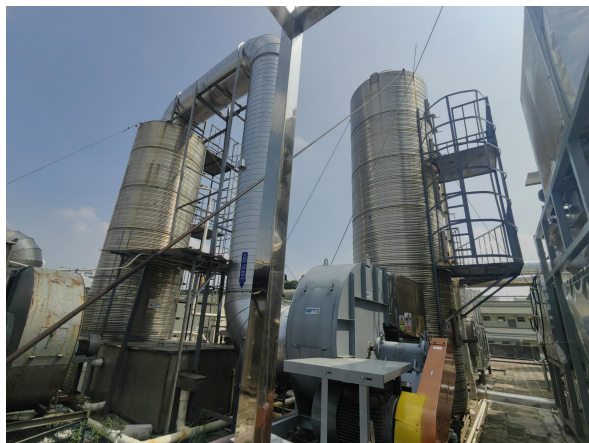
2 喷 2 烤防堵塞式离心分离吸收塔 1、2
