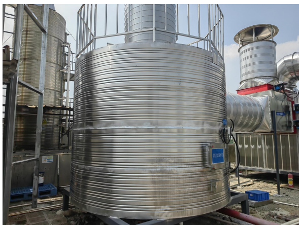
填料过滤脱水塔
